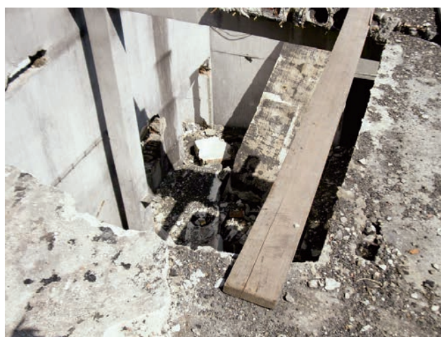
Fot. 2. Skuwanie stropu, brak zabezpieczeń – ciężkie uszkodzenia ciała
