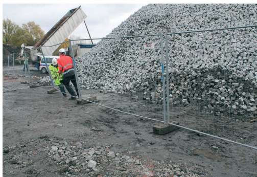
Rys. 1. Napieranie na ogrodzenie
